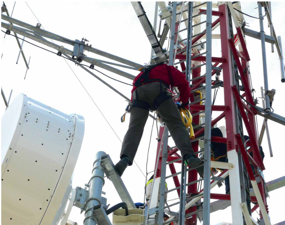
Sistema anticaídas en escalera fija.
