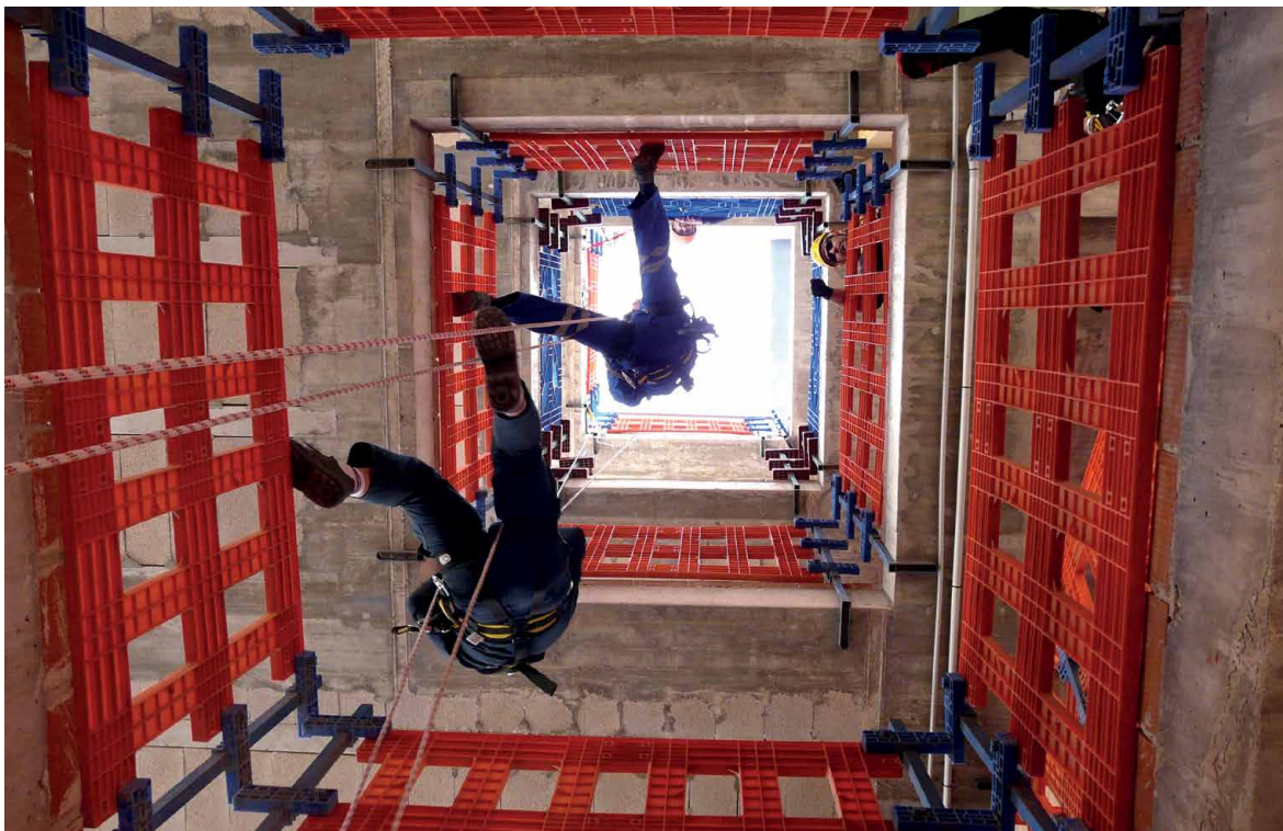
Vallado en zonas con riesgo de caída.
