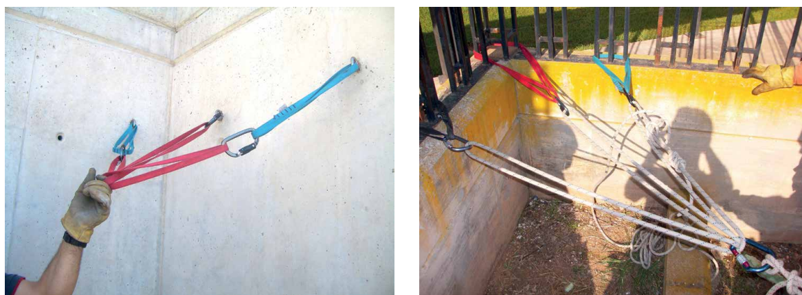
Cabecera en estructuras metálicas, con anclajes transportables EN 795 B.
