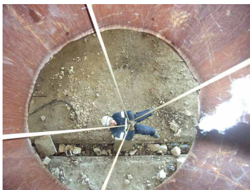
Anclajes de fortuna.
