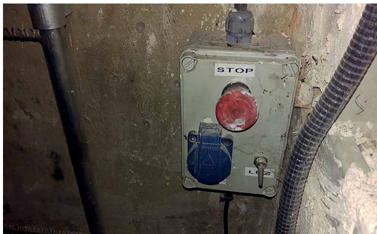
El pulsador de seguridad STOP (seta).
