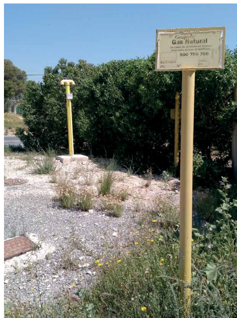
Hito de gaseoducto y sifon de ventilación.
