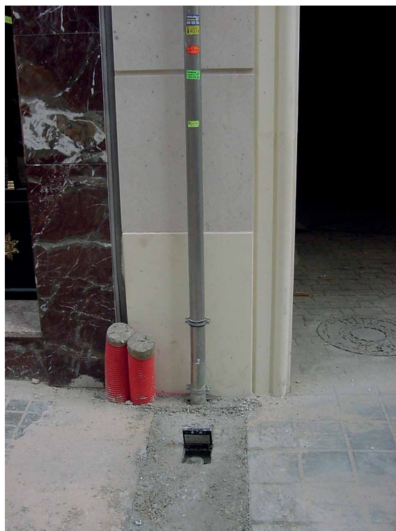
Tubería alojada en vaina.
