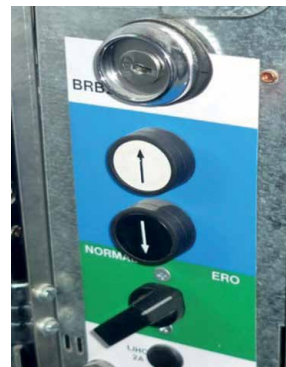
Maniobra eléctrica de socorro.
