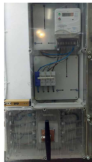
Fusibles en cuarto de contadores.
