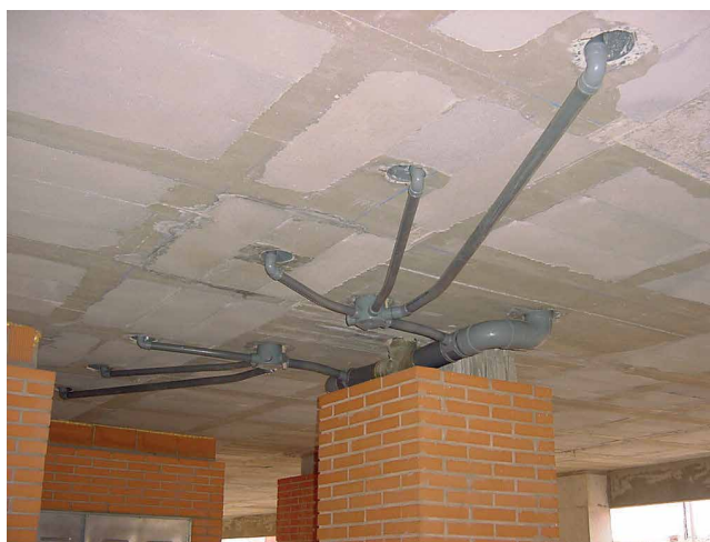
Red Pequeña evacuación.
