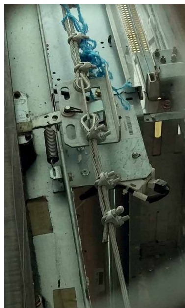
Anclaje del paracaídas al cable del limitador.
