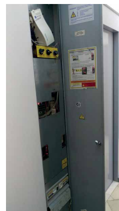
Acceso a cuadro de maniobra.
