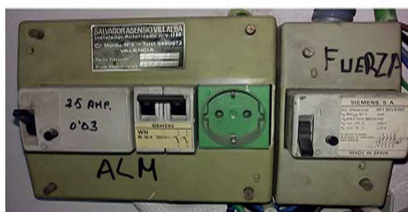
Distintos cuadros de protección eléctrica.
