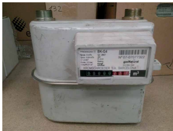
Contador de gas.
