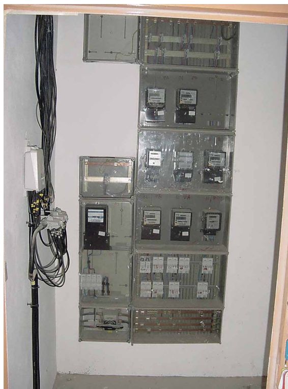
Centralización de contadores.
