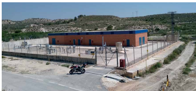
Estación reductora de presión.
