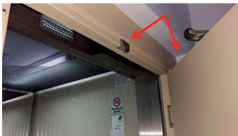
Llave en alojamiento puerta de planta.
